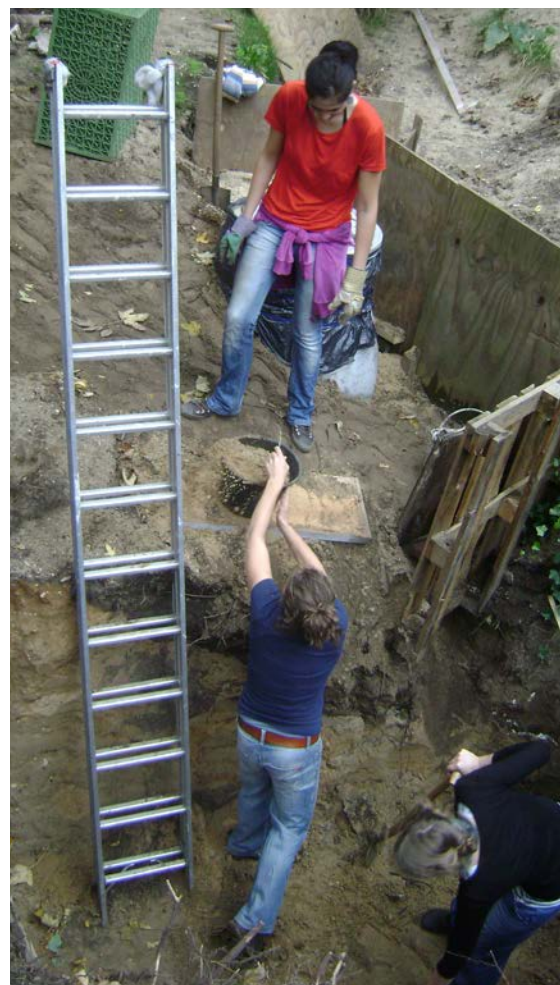
Op de plaats van de oude olietank is een gat gegraven voor de infiltratiekratten.
