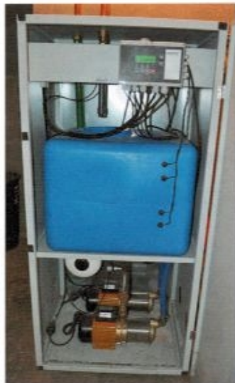
De systeemtank van 170 liter is steeds vol om aan de watervraag te voldoen
