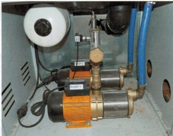
De Rainmanager is voorzien van twee pompen om de toevoer naar de zeventig aftakpunten te voorzien. De pompen werken in cascade om problemen te omzeilen
