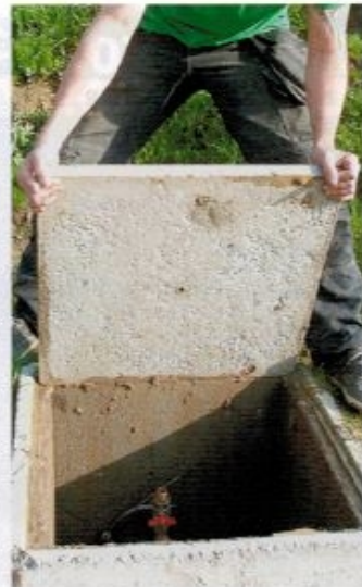
Het regenwater van alle daken wordt verzameld in vijf regenwaterputten
